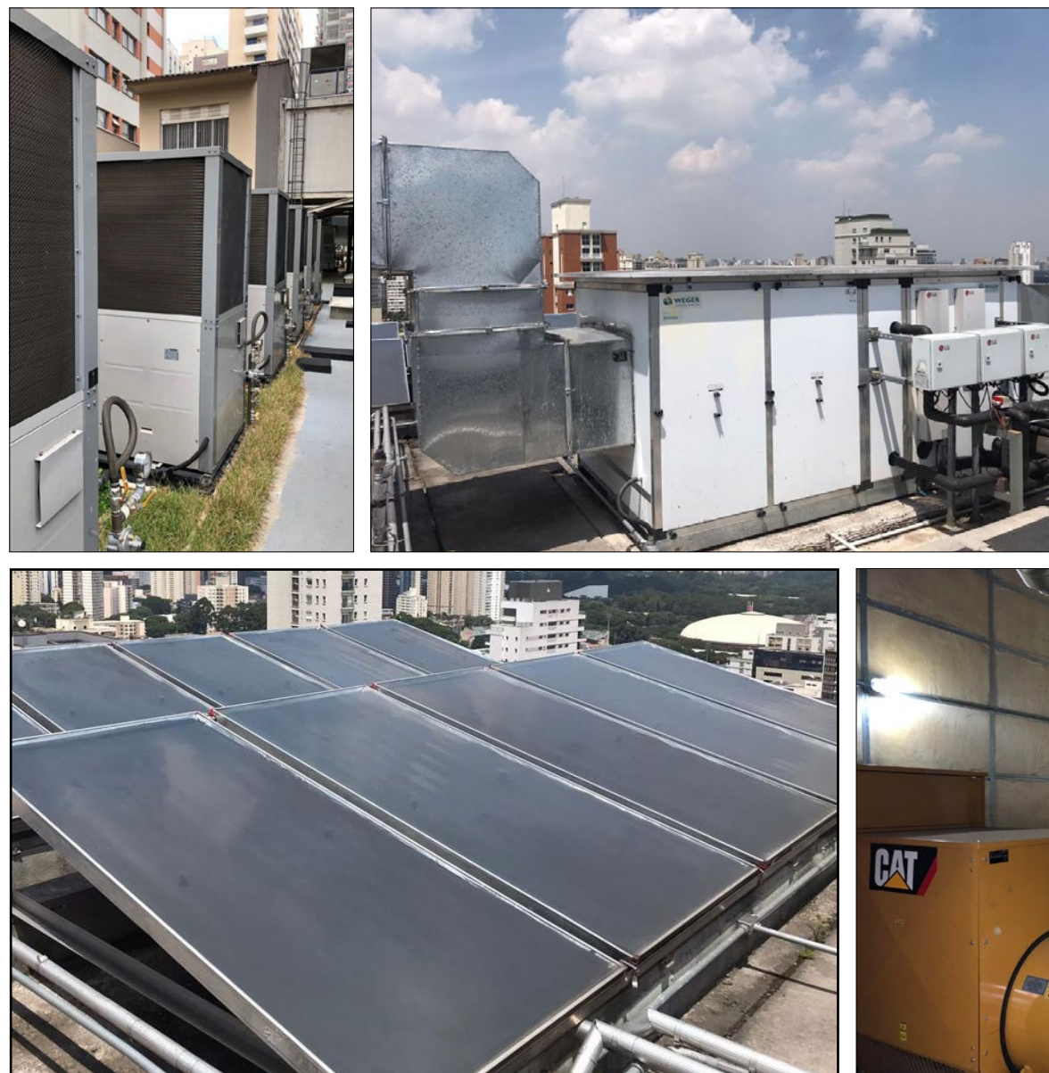
Sistema de ar condicionado a gás; gerador a gás; e conjunto de placas fotovoltaicas.
